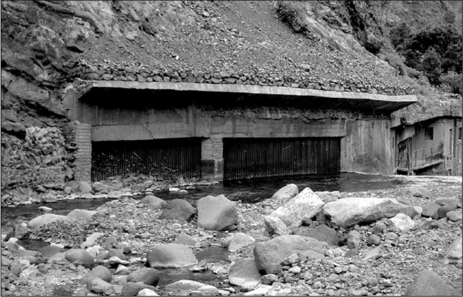
Foto 1: Tomadero de Dos Aguas en la confluencia del arroyo de Taburiente y del Almendro Amargo.
